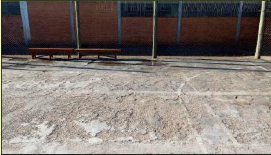
Figura 2 - Quadra em más condições
