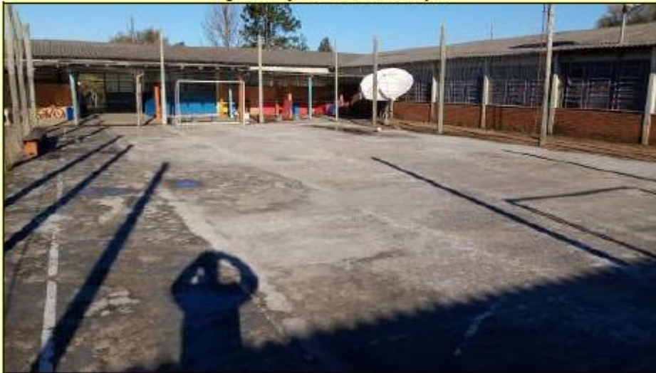
Figura 3 - Quadra em más condições
